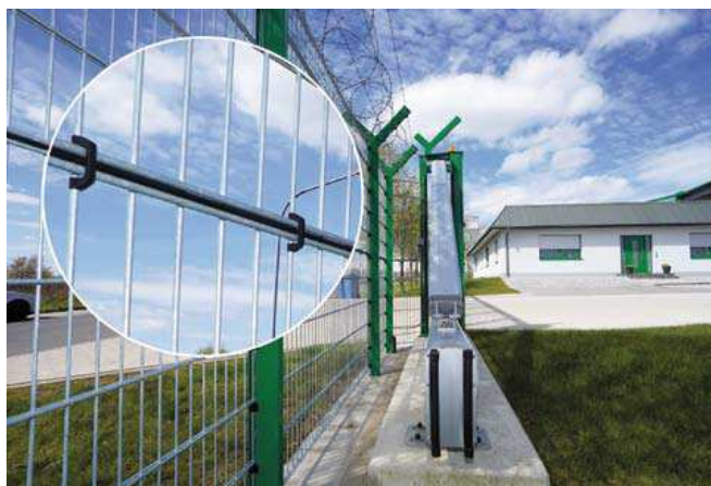
PeriNet Dreifachstabgitter: Der Zaun, als Mechanisches Sicherheitssystem, fungiert dabei als Träger für eigens zu diesem Zweck entwickelte Sensorkabel.
